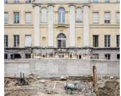
Abb. 4: Errichtung des Altstadtringtunnels unter dem bestehenden Prinz-Carl-Palais Ende der 1960er-Jahre, Bild mit freundlicher Genehmigung des Baureferats der Landeshauptstadt München
